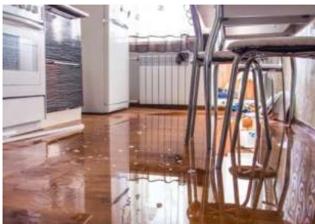
Рис. 4. Последствия прорыва трубы
